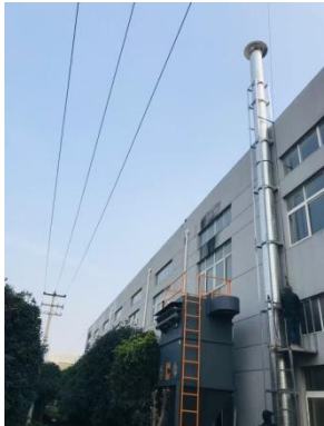
废气处理设施及排放口 DA001
