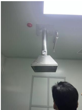
生产车间内集气装置
