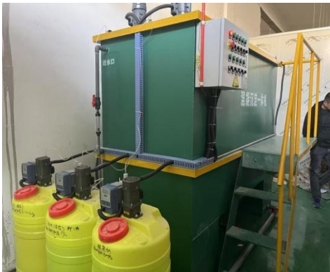
一体化污水处理设施
